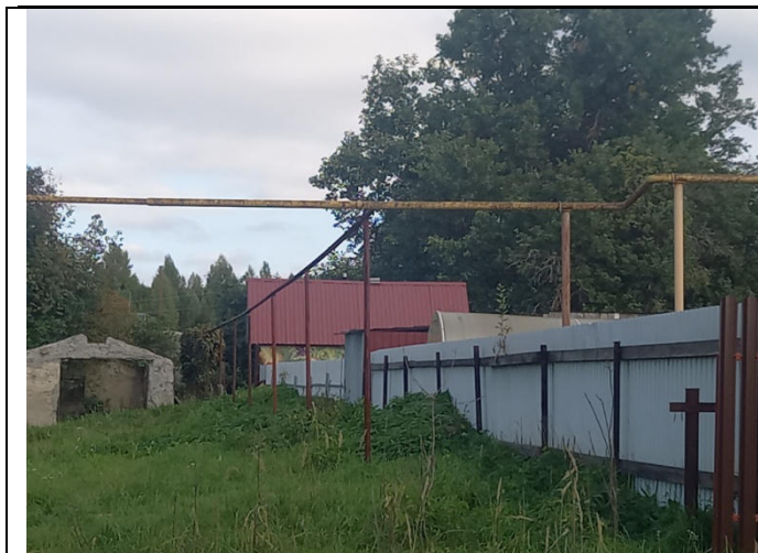
Газопровод по ул.Зеленая
